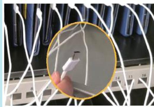
작은 충전부 파손
